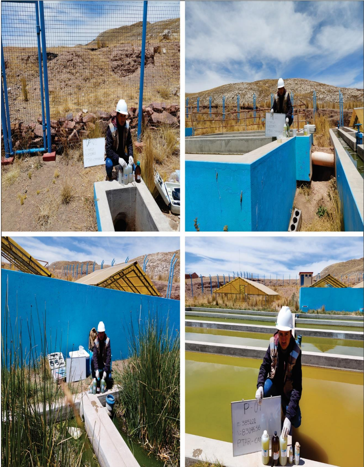
Figura 14. Puntos de monitoreo en la planta de tratamiento de Caminaca.
