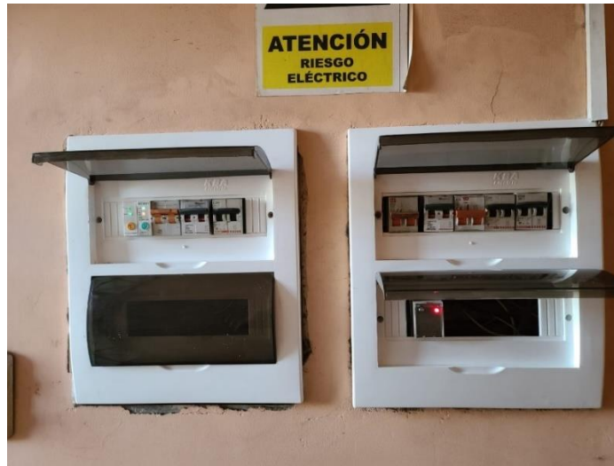
Figura 3.5.11 Sistema de protección y monitoreo del SFCR – Independencia.
