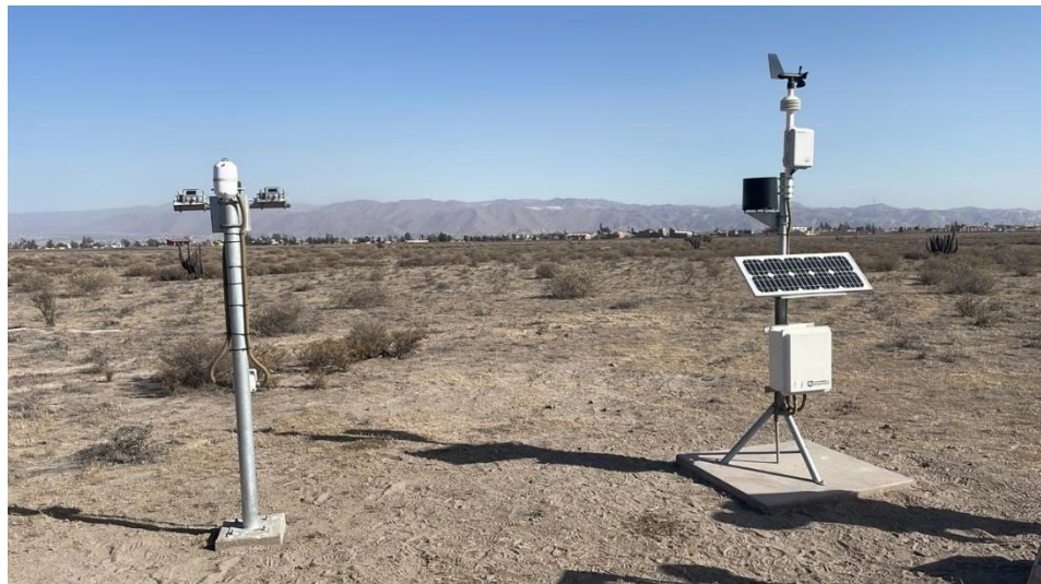
Figura 3.5.4.1 Equipos de monitoreo Aeropuerto Alfredo Rodríguez Ballón.
