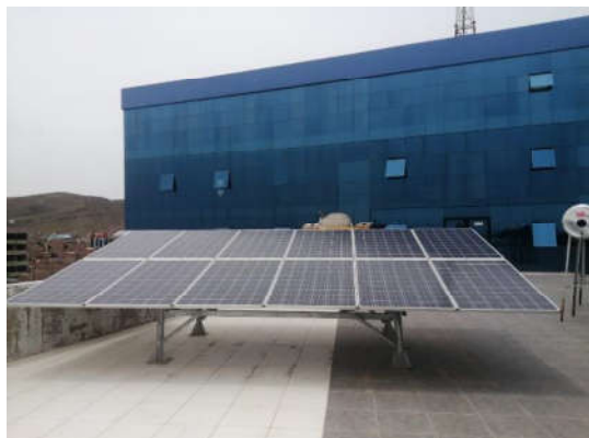
Figura 1. Generador fotovoltaico instalado en el pabellón administrativo de la UNAJ.
