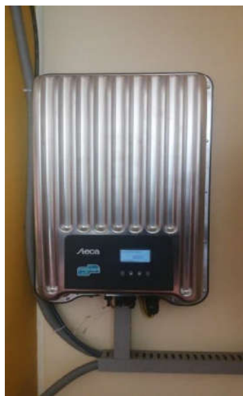
Figura 2. Inversor instalado en el laboratorio de control y automatización en pabellón administrativo de la UNAJ.
