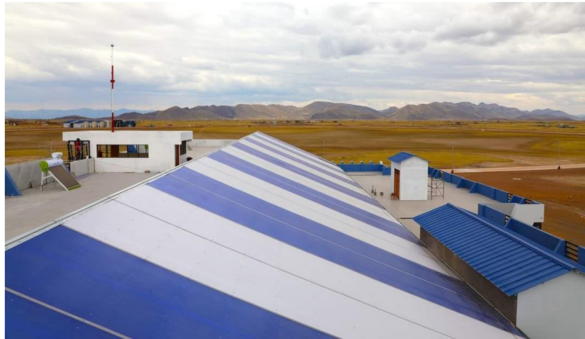
Figura 3.28: Ubicación en la Azotea de la instalación del sistema fotovoltaico (Fuente Propia).
