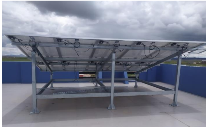
Figura 3.31: Montaje de estructura de soporte y paneles fotovoltaicos concluido; g) vista isométrica; h) vista posterior (Elaboración propia).
