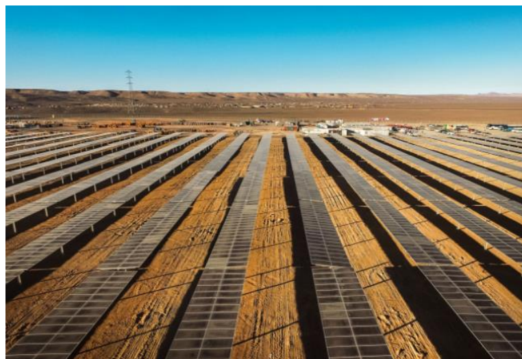
Figura 2. Central fotovoltaica Rubí de Moquegua con una generación de hasta 180 MW (Enel, 2018).
