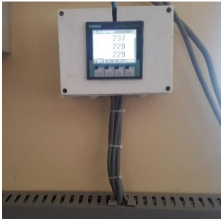
Figura 13. Tablero eléctrico y ubicación del SENTRON PAC 3200
