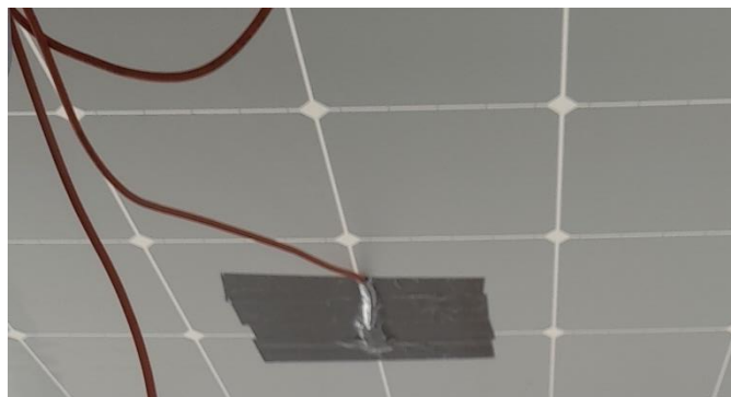
Figura 17. Sensor de temperatura PT100 adherido a la parte posterior del panel fotovoltaico del SFCR.
