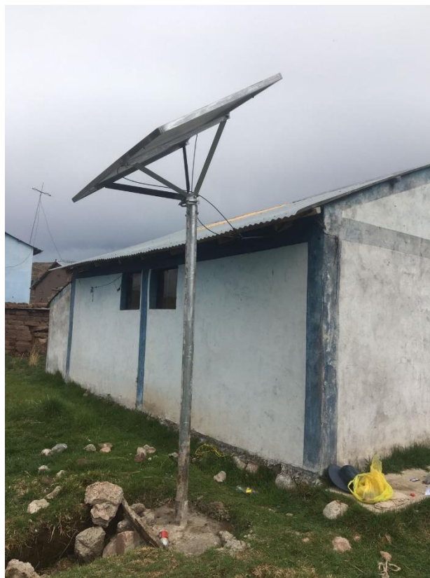
Figura 21. Soporte del módulo fotovoltaico.
