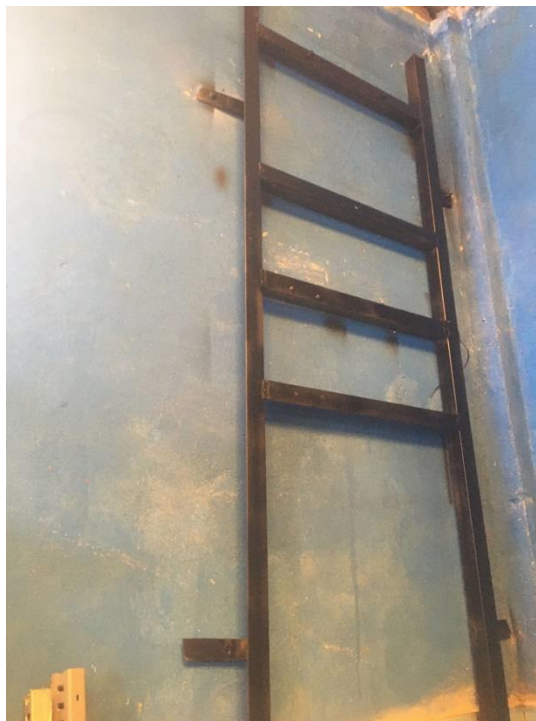
Figura 23. Soporte de equipos electrónicos.
