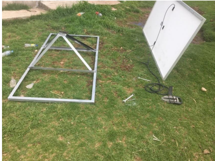
Figura 20. Soporte base del módulo fotovoltaico.
