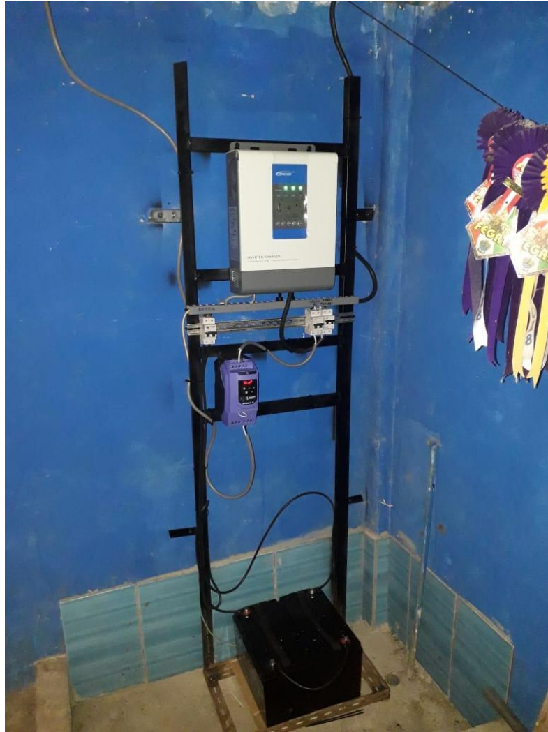
Figura 24. Soporte de equipos electrónicos instalados.
