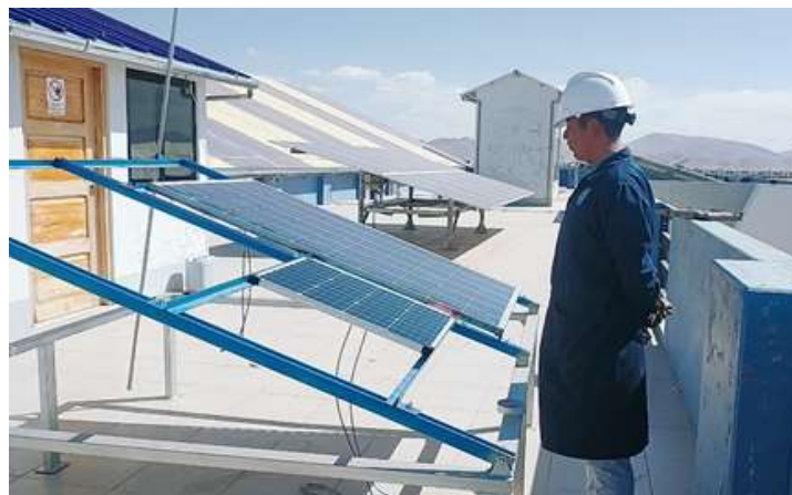
Figura 61. Inspección visual del módulo fotovoltaico.
