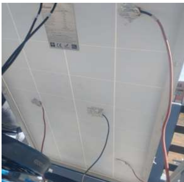
Figura 67. Sensores de temperatura colocados en la modulo fotovoltaico.
