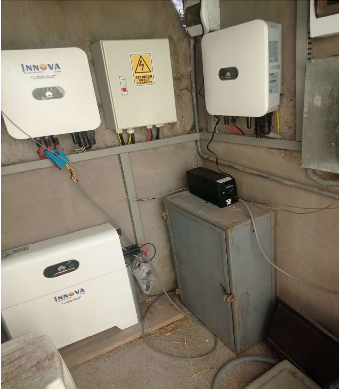
Anexo 2 Imagen de la batería de ion de litio y con inversores a red
