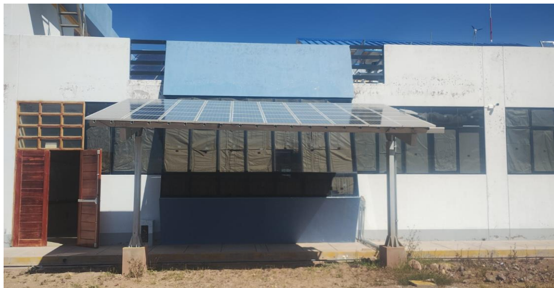
Figura 11. Vista externa del sistema fotovoltaico (Fuente propia).
