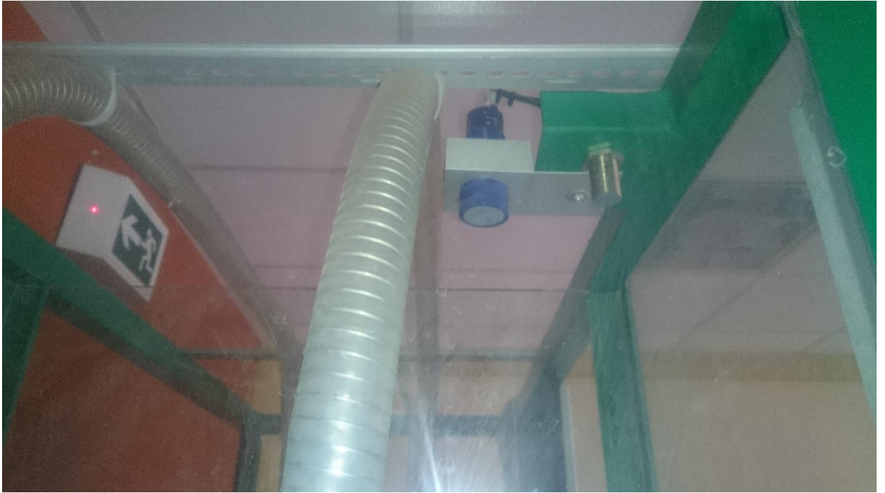
Sensores de Nivel, agosto del 2016
