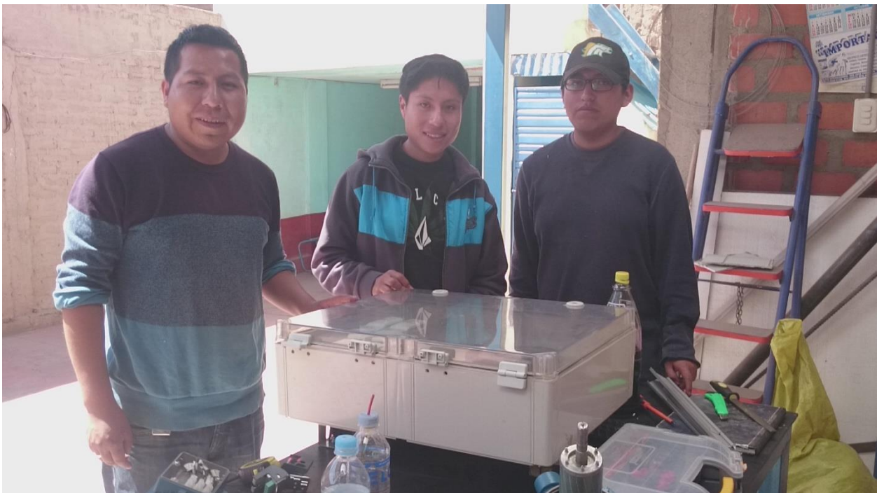
Instalación del tablero de Control del sistema Hidráulico, Tapa de Control, junio del 2016
