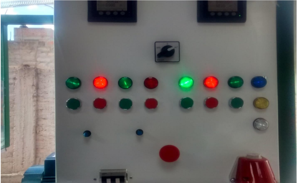
Panel de Control del Módulo Hidráulico, agosto del 2016
