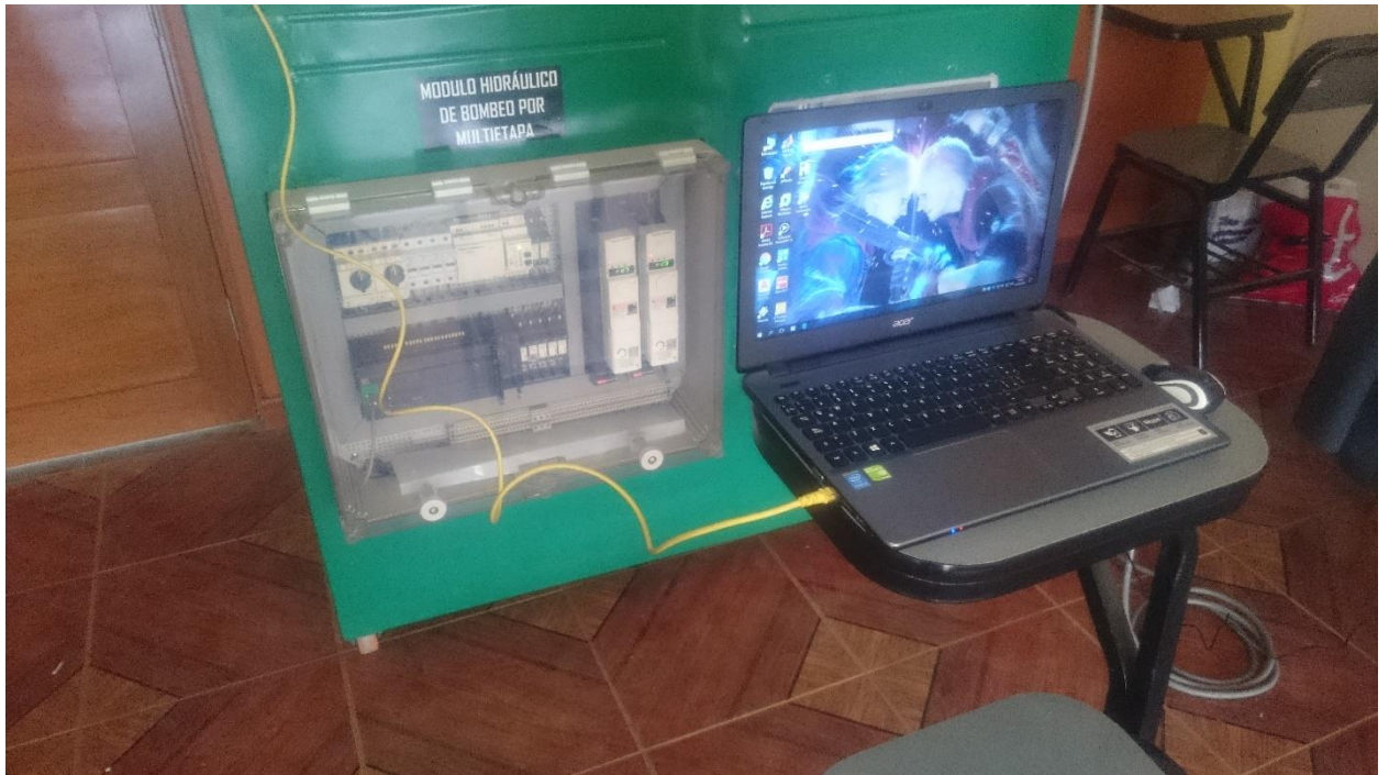
Verificando el sistema de Monitorización del Módulo Hidráulico, abril del 2017
