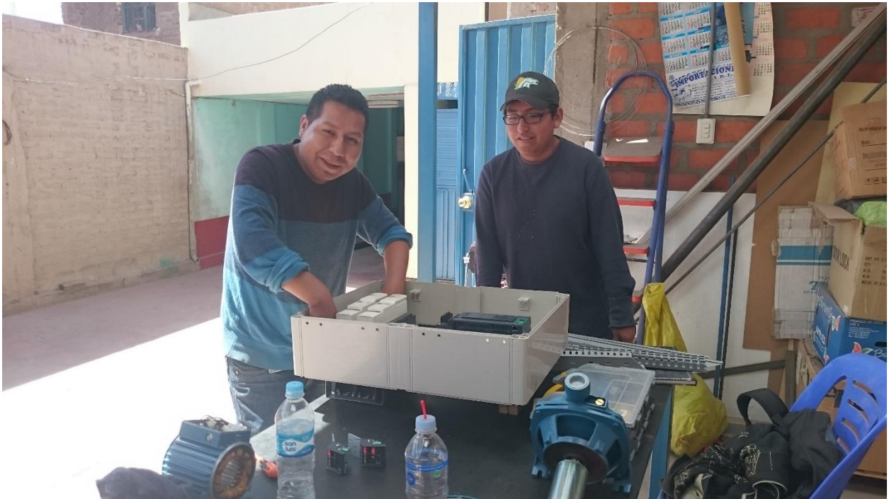
Instalación del tablero de Control del sistema Hidráulico, Variador de Frecuencia, mayo del 2016
