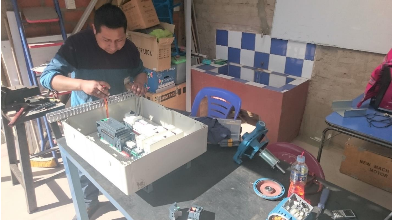
Instalación del tablero de Control del sistema Hidráulico, PLC, mayo del 2016
