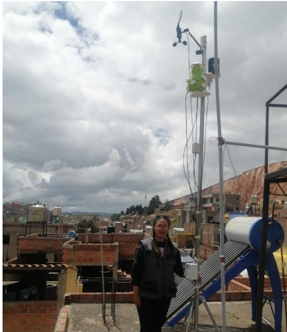
Foto 1 Instalación de punto de monitoreo
