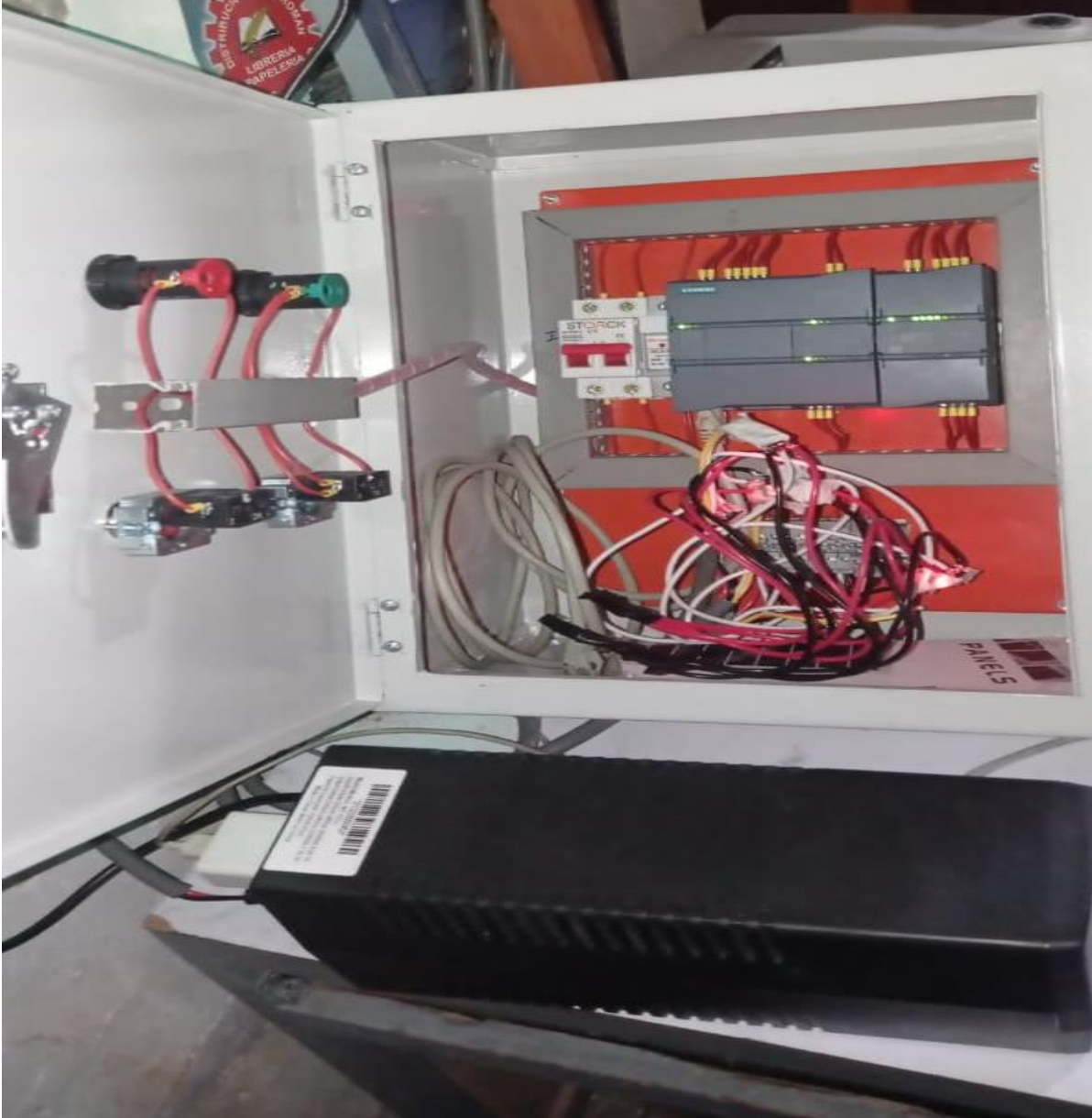
Nota: módulo de medición y circuito de protección del sistema de iluminación instalado en el gabinete para su protección.
