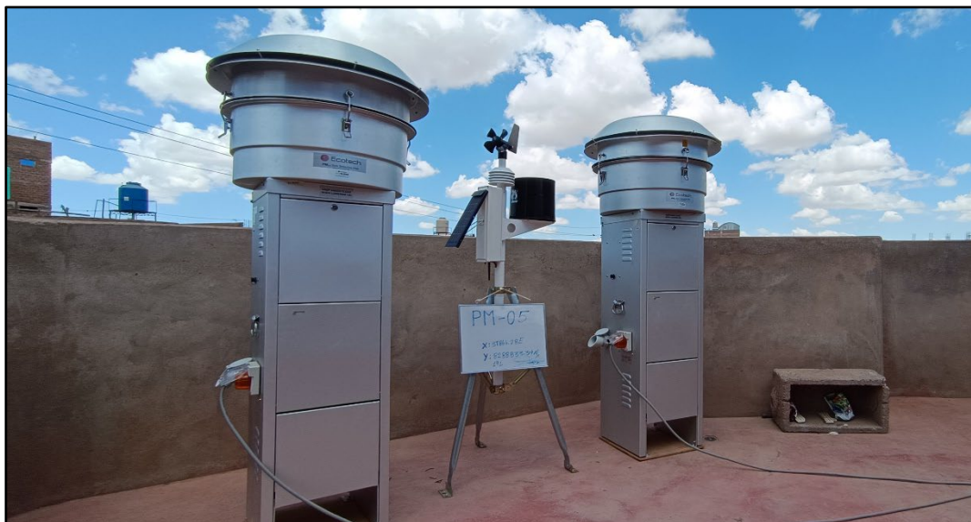
Figura 23. Instalación de equipos de monitoreo de PM 2.5 y PM 10 y estación meteorológica.
