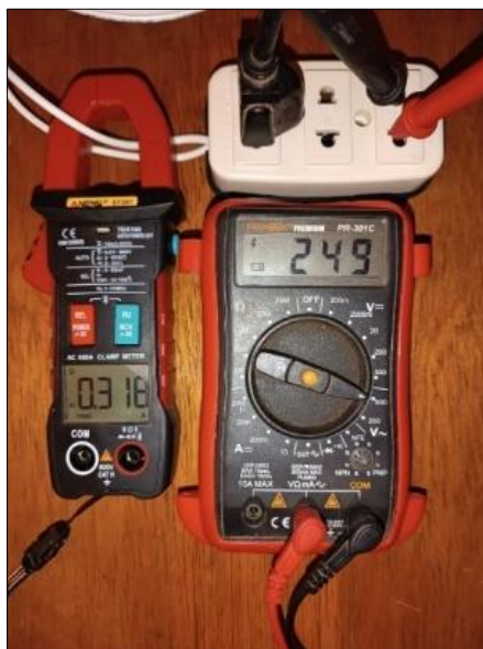
Figura 16. Herramientas utilizadas para la determinación del cuadro de cargas. Fuente: Elaboración propia (2025).
