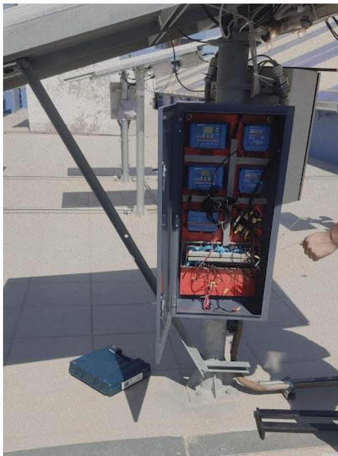
Nota. Instalación del tablero de control en el mono poste 2x2 de módulos solares poli cristalino y mono cristalino.
