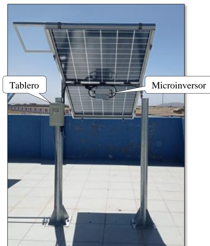
Figura 25. Instalación de microinversor y tablero de medición de energía en CC.
