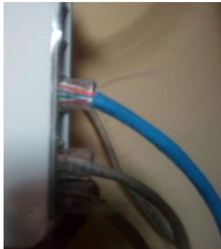
Figura 16. Comunicación por cable ethernet
