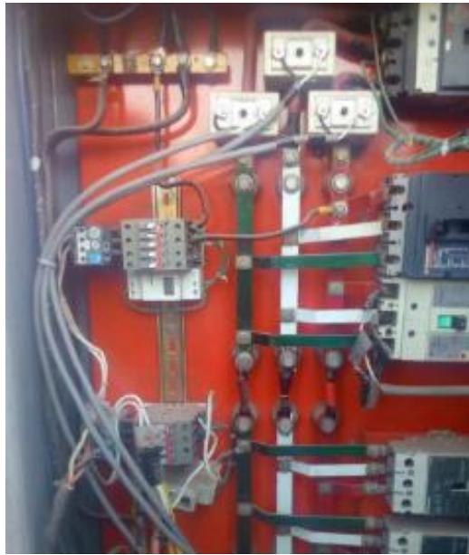
Figura 14. Conexión del sentron PAC3200 con las fases del tablero de distribución
