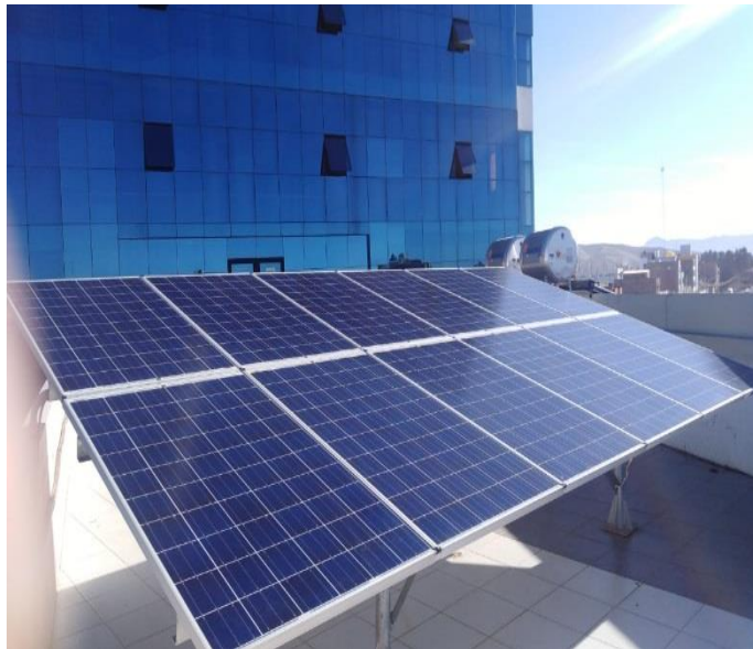
Figura 20. Fotografía de los paneles fotovoltaicos y soporte de estructura metálica
