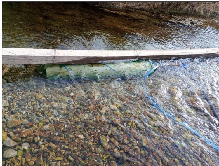
Figura 48. Bomba sumergible Nastec Multipower implementado en la comunidad campesina de Selque.
