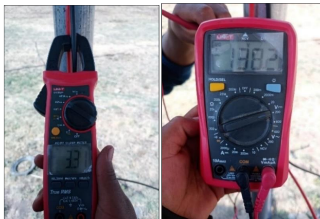
Figura 45. Medición del consumo de potencia de la bomba sumergible.
