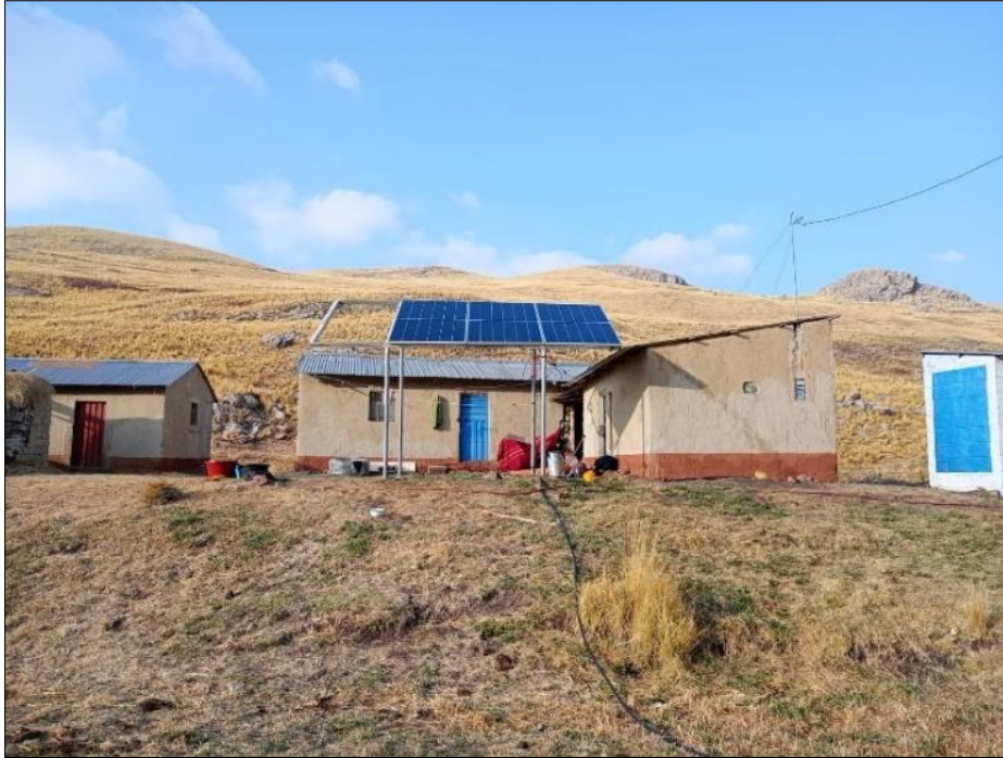
Figura 49. Sistema de generación fotovoltaica de 1,41 kw implementado en la comunidad campesina de Selque.
