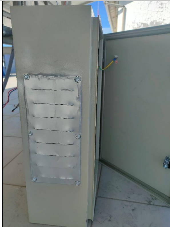
Ventilación del Inversor/cargador.
