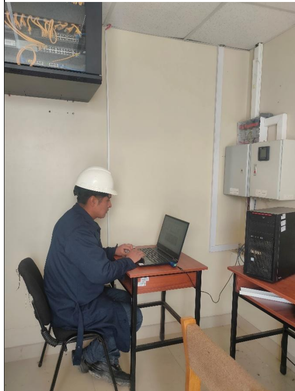
Verificación de monitoreo LabVIEW.
