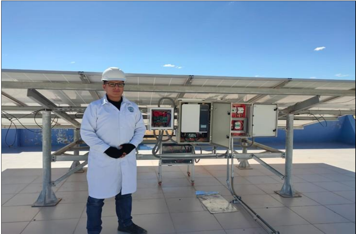
Proyecto implementado en la fase operativa.
