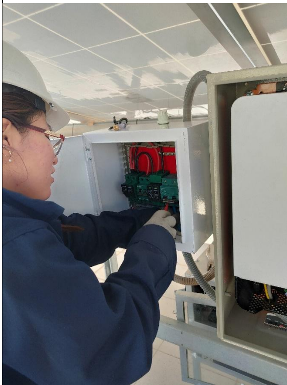
Conexión de tablero protección DC.
