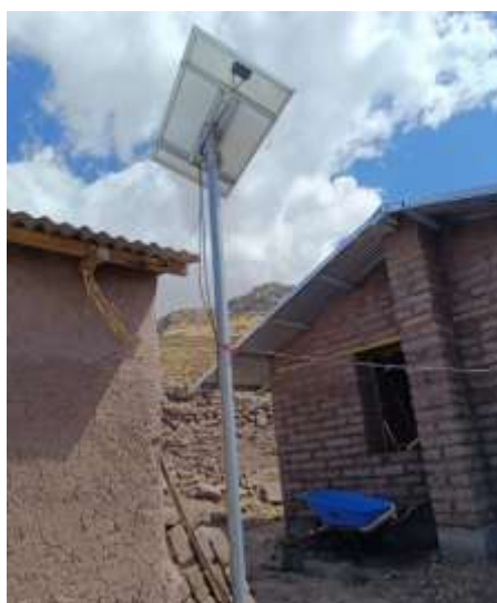
Figura 21. Instalación RER Autónoma de Tipo 1.
