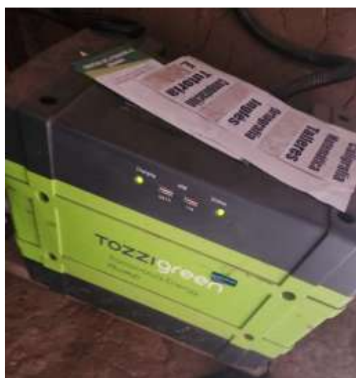
Figura 36. Energy Box del SFD RER 1.
