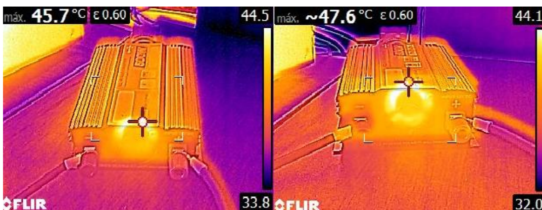
Figura 74. Muestra la imagen en medición de temperatura de inversor de alta frecuencia con la cámara termográfica.
