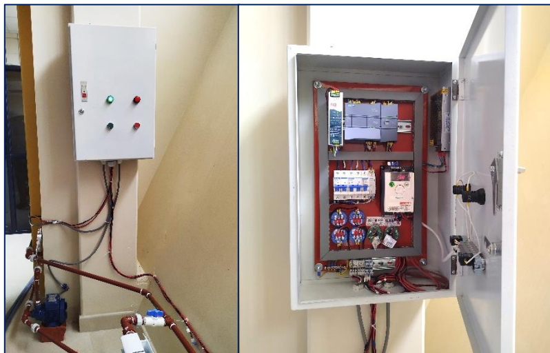
Figura 75. Tablero de control instalado.
