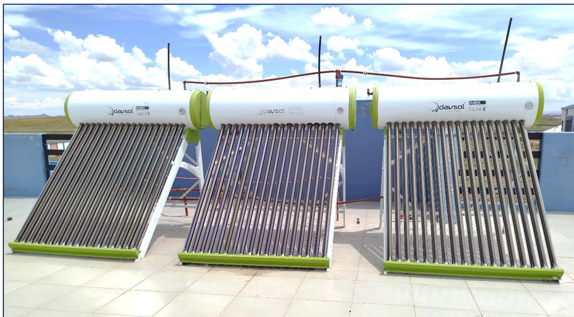
Figura 73. Calentadores solares instalados.
