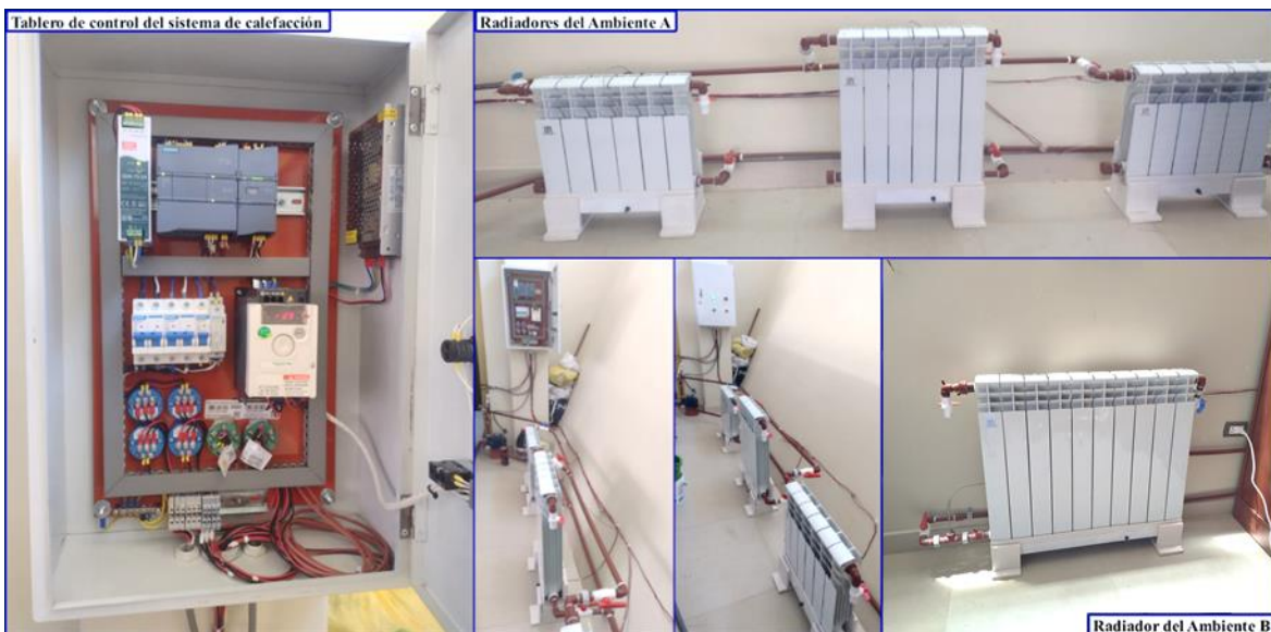
Figura 77. Imágenes de los radiadores y del tablero del sistema de calefacción.
