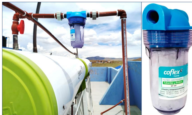
Figura 31. Tratamiento químico del agua mediante filtro con sales de polifosfato.
