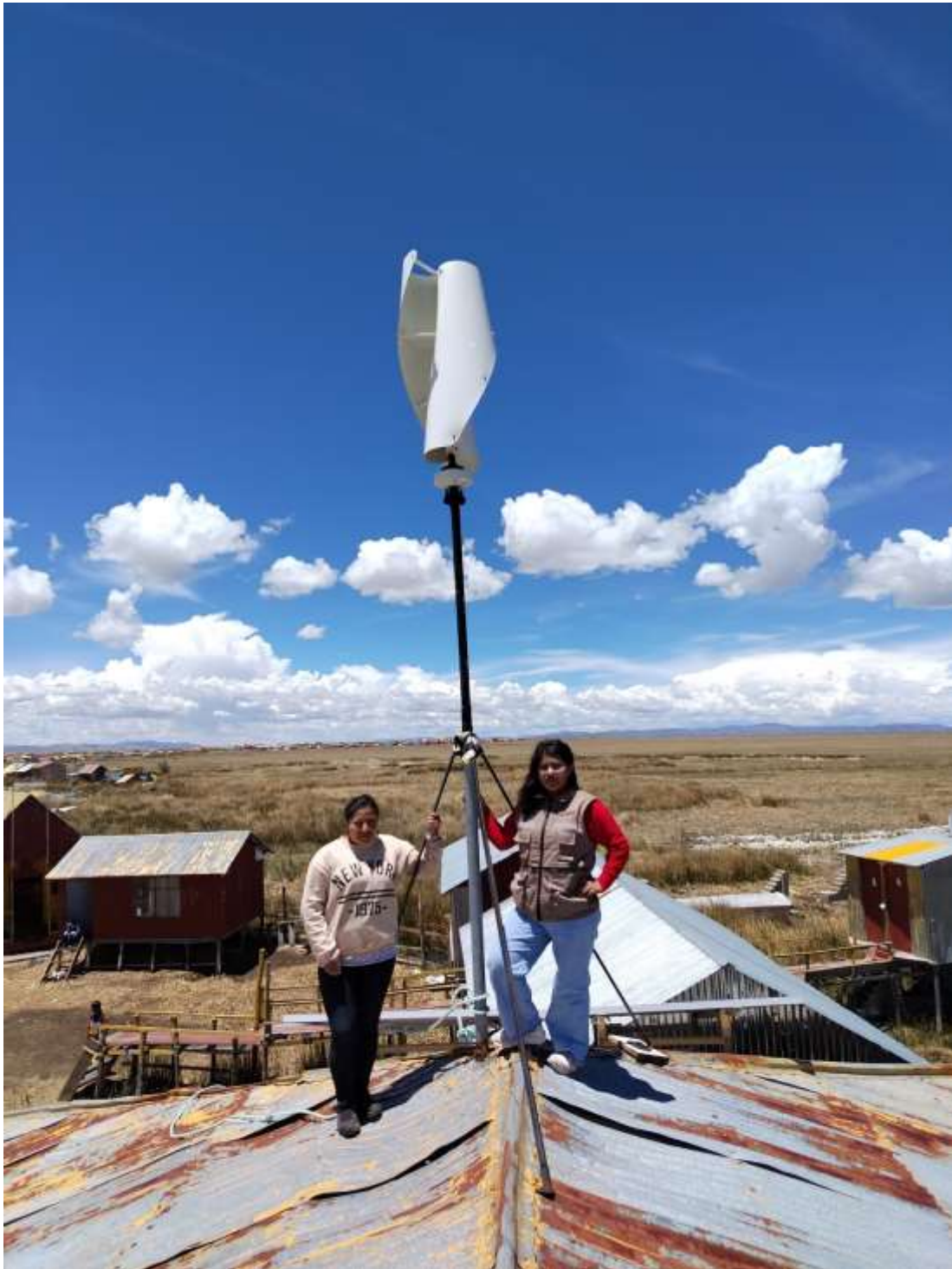
Anexo 11: Lugar de instalación de turbina savonius, en funcionamiento
