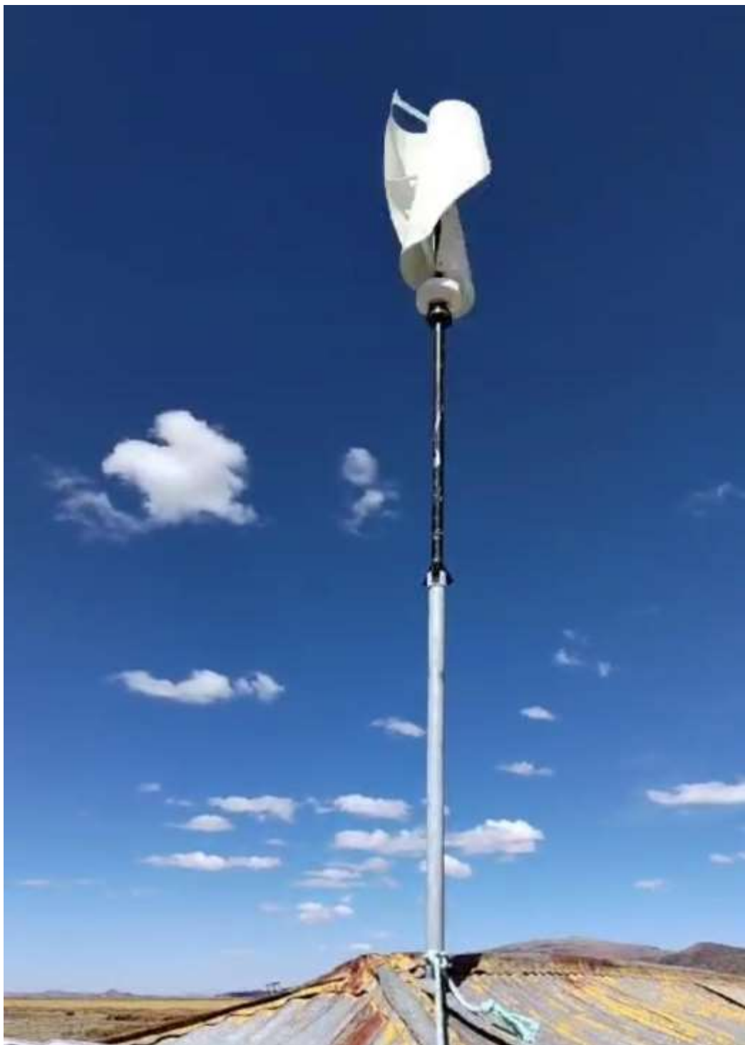
Anexo 8: Sistema eólico tipo savonius instalado en la Isla Urus Puno
