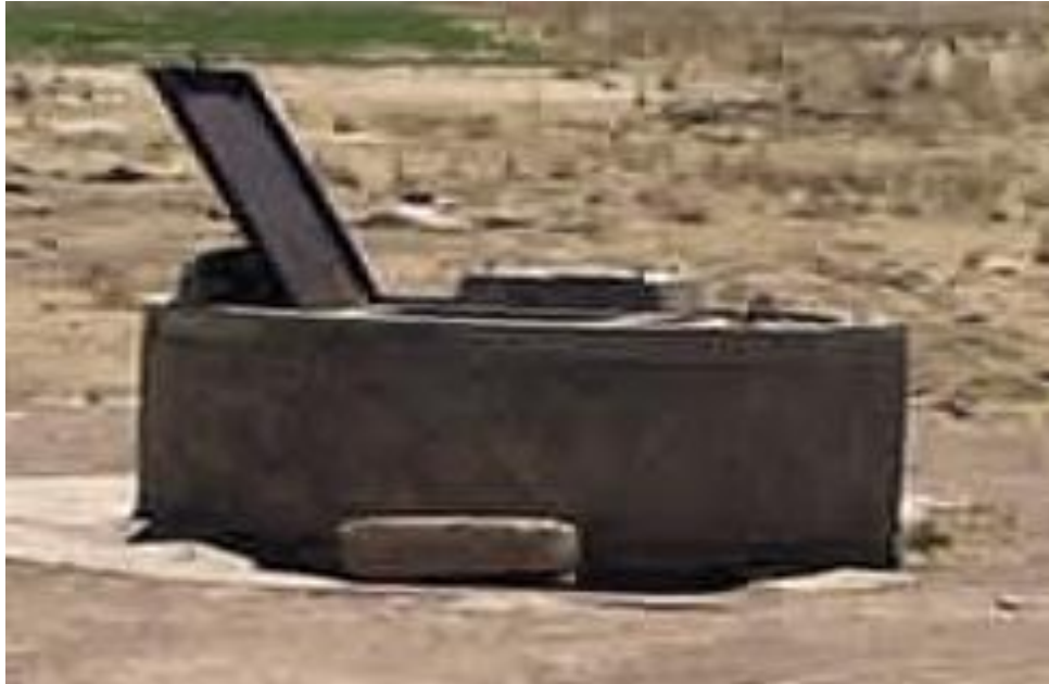
Pozo tubular de la localidad Tacamani
