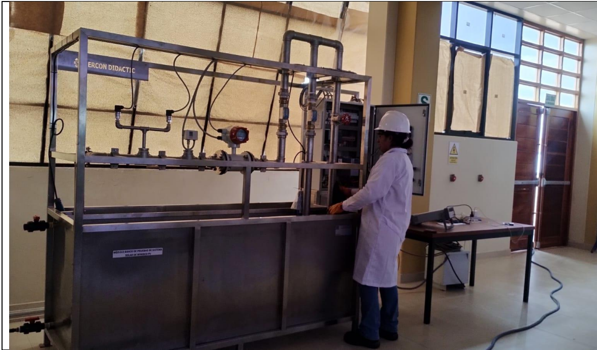
Programando los parámetros de la bomba sumergible en el tablero de control
