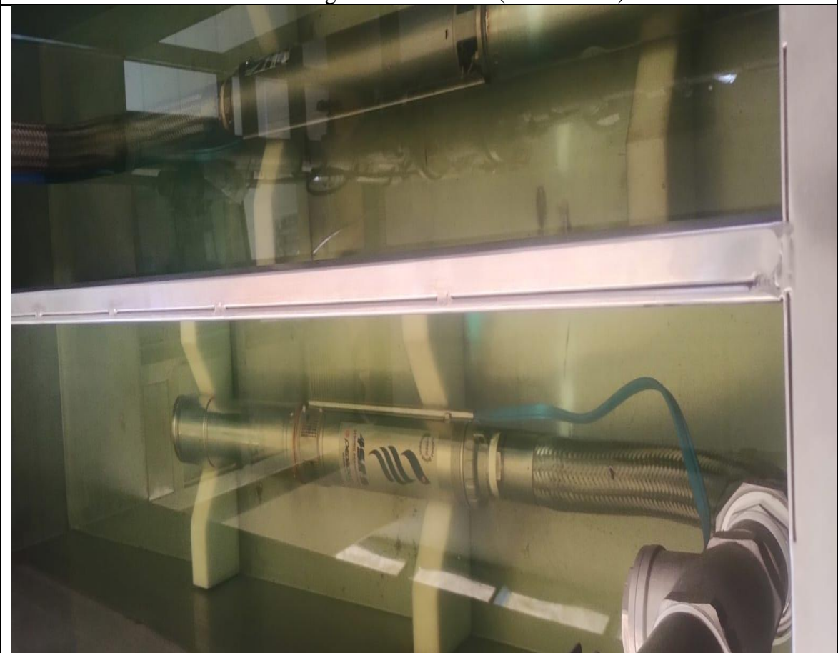
Funcionamiento de la bomba Pedrollo
