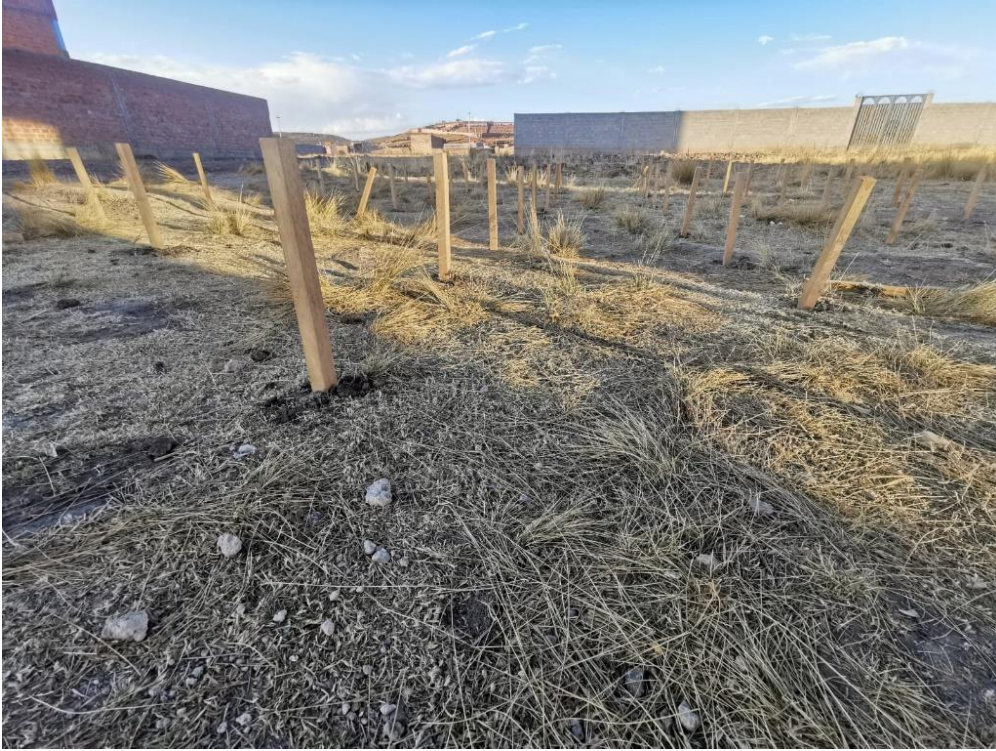
Anexo 2. 7 Cementerio de estacas y degradación de las maderas
