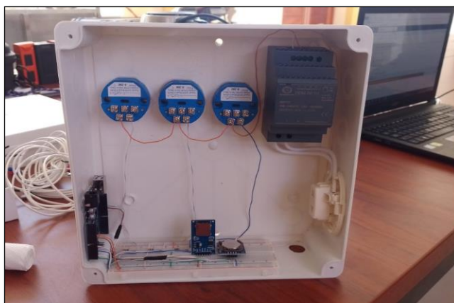
Figura 24. Tablero de adquisición de datos de temperatura.
