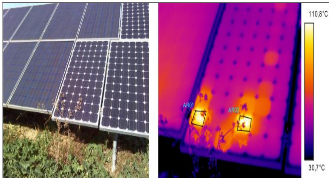
Figura 7. Sombreado en un módulo fotovoltaico (Alvarez, 2018).
