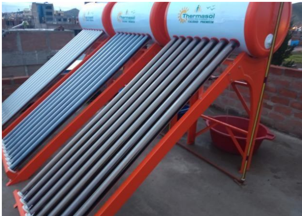
Figura 3.5: Termas solares instaladas a un ángulo de 35° de inclinación
