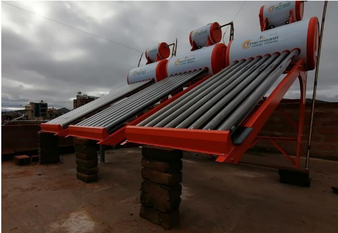
Figura 3.6: Termas solares instaladas a un ángulo de 25° de inclinación
