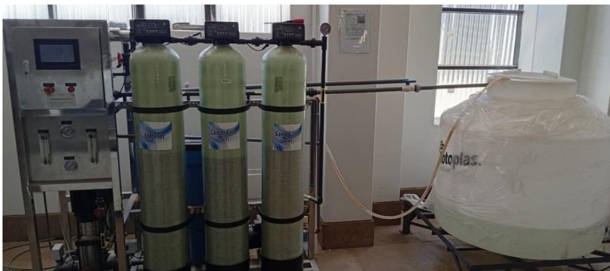
Figura 12: Equipo ablandador de agua por ósmosis inversa.
