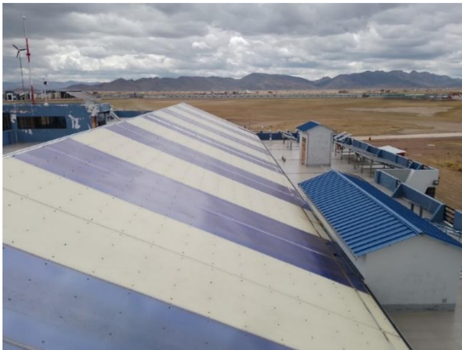
Figura 45. Área techada de policarbonato del instituto de energías renovables – UNAJ.
