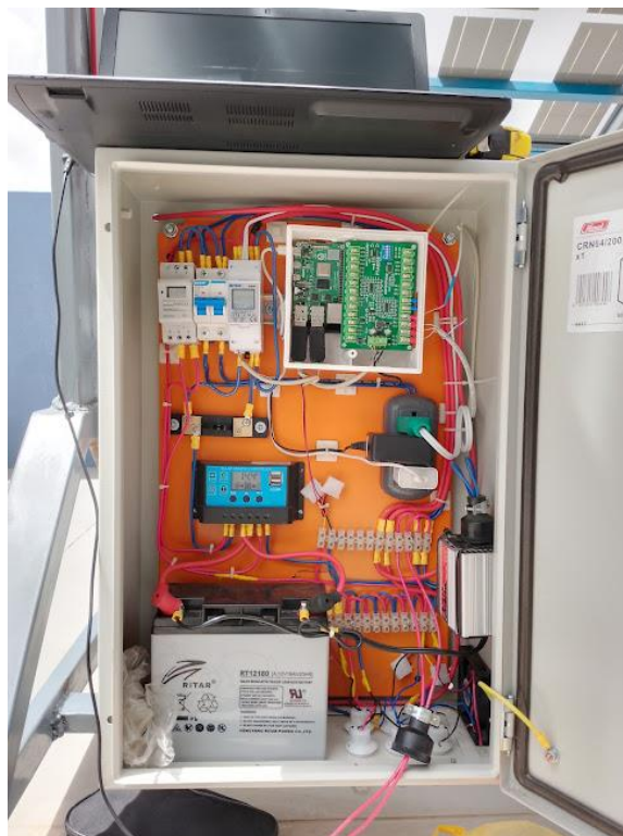
Figura 21. Tablero para la adquisición de datos.
