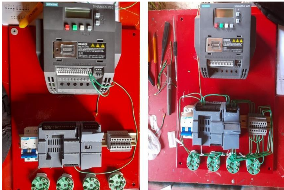
Figura 63. Adecuación de equipos de control.
