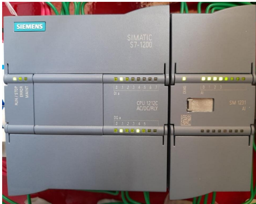
Figura 15. Controlador lógico programable de marca SIEMENS Simatic S7-1200.
